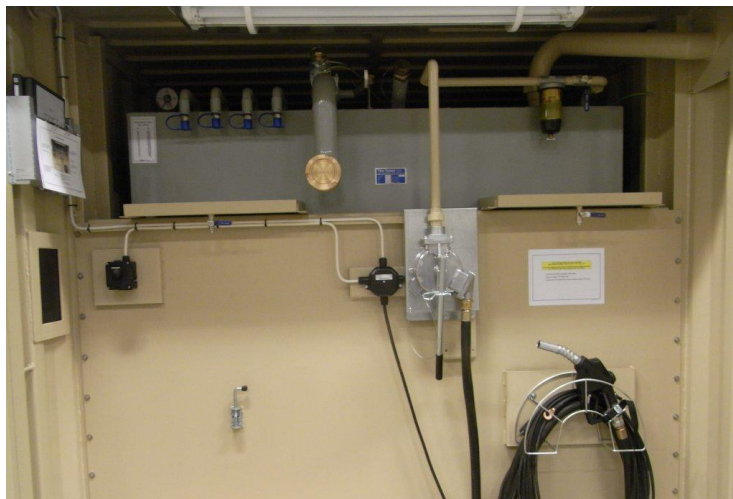
Invallning och manuell ATEX-fyllningspump
